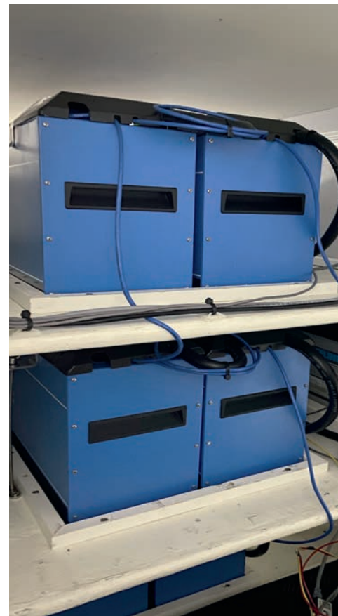
Litiumbatterier på hylder
