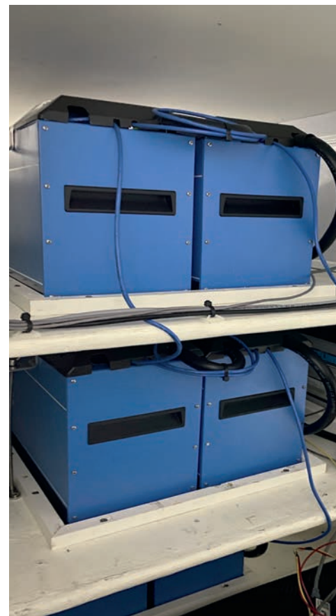
Lithiumbatterier på hyller
